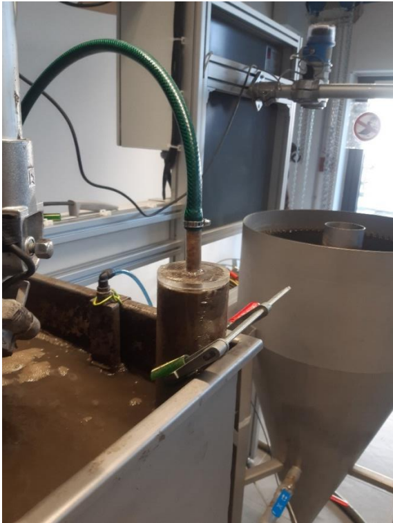
Abbildung 3 Steigrohr zur Überschussschlammmentnahme (oben) und Rinne mit Zahnschwelle zum Überschussschlammabzug (unten)
